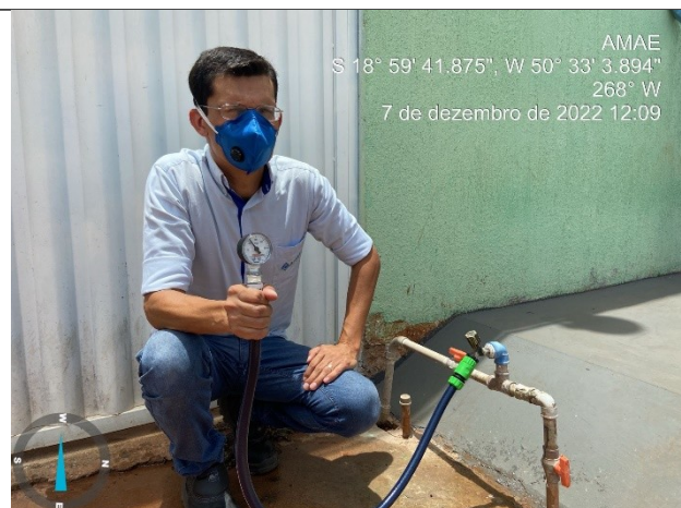
Autor: AMAE Descrição: Equipe da AMAE realizando aferição de pressão em rede de distribuição de água, no município de São Simão.
