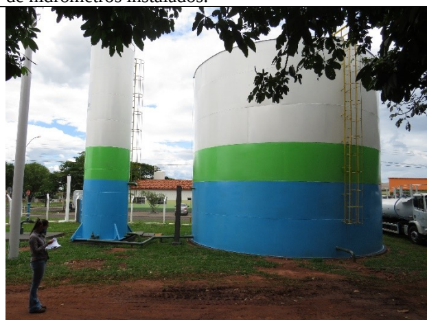
Autor: AMAE Descrição: RAP e REL Vila Bela 1, em condições adequadas de operação.
