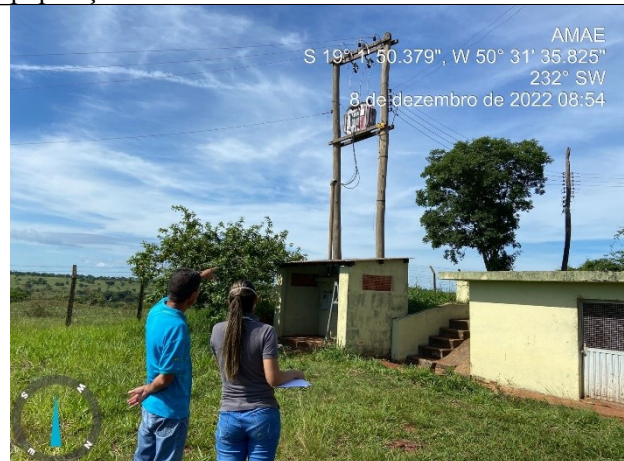
Autor: AMAE Descrição: Cabo de energia que liga o painel de comando ao transformador que foi substituído.
